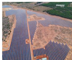
Nhà máy điện mặt trời Hồng Liêm 3 - Xã Hồng Liêm, huyện Hàm Thuận Bắc, tỉnh Bình Thuận
