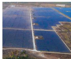
Nhà máy điện mặt trời Phan Lâm 2 - Xã Phan Lâm, huyện Bắc Bình, tỉnh Bình Thuận
